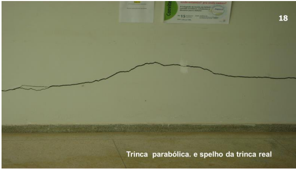
Figura 5. Trinca real ilustrando a figura anterior mostrando inclusive que a flexão de uma laje sob carregamento uniforme é uma parábola, espelho invertido da laje real
