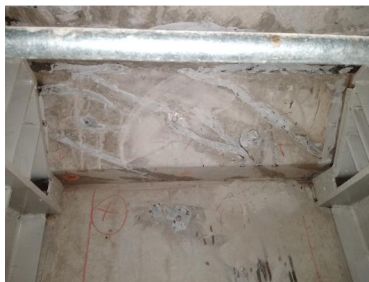
Figura 2. Trincas e reforço no túnel.
