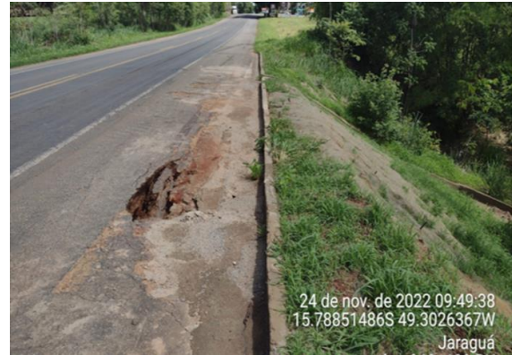
Figura 3. Vista da cavidade detectada no acostamento da pista.
