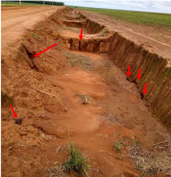
Figura 2. Cavidades devidas à erosão subterrânea expostas nas margens da rodovia
