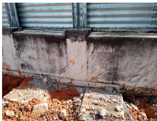
Figura 1. Trincas e Fissuras observadas na face do silo.
