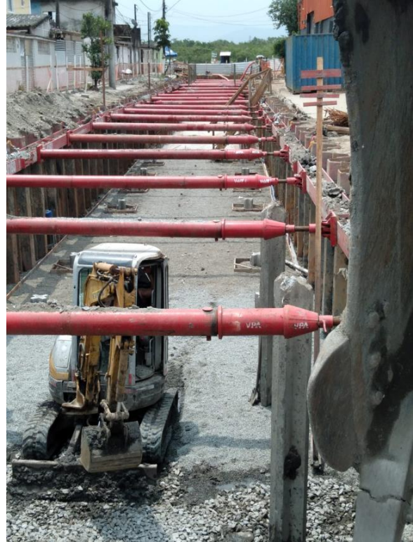
Figura 4. Estroncamento modular ajustável aplicado com estaca prancha em uma obra de infraestrutura localizada em Guarujá-SP.
